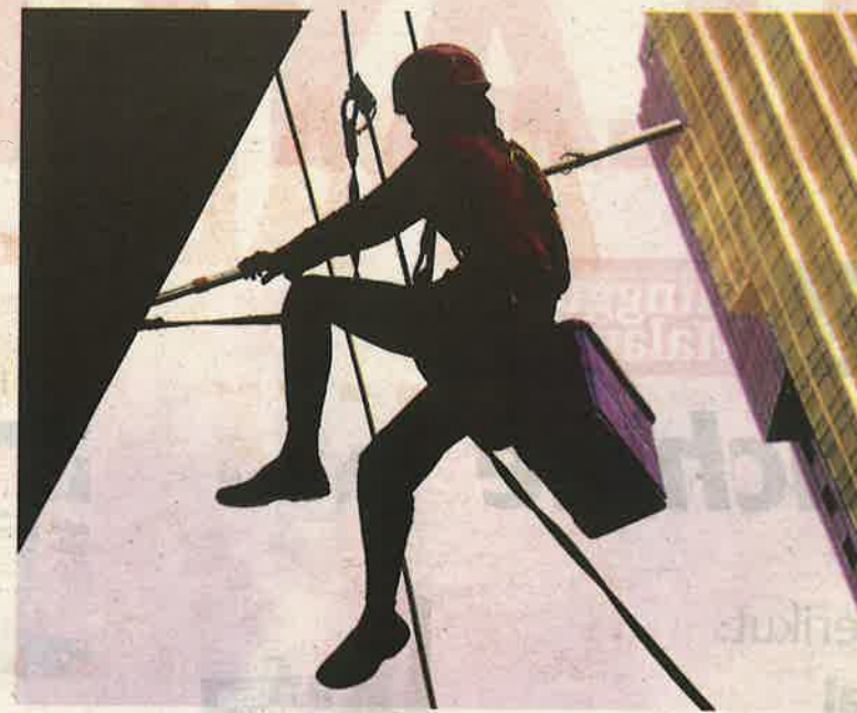
SEORANG buruh bertugas mencuci cermin di bangunan Quattro West, Petaling Jaya. Kerajaan perlu menubuhkan pusat tenaga kerja kebangsaan bagi merekrut lepasan Sijil Pelajaran Malaysia (SPM) yang tercicir atau tidak melanjutkan pengajian ke peringkat tinggi. - UTUSAN/ASWAD YAHYA
